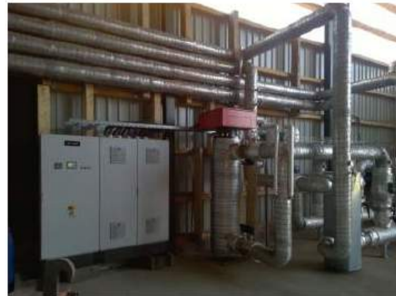
Schaltschrank 1000 KW & 1000 KW PtH- Modul
